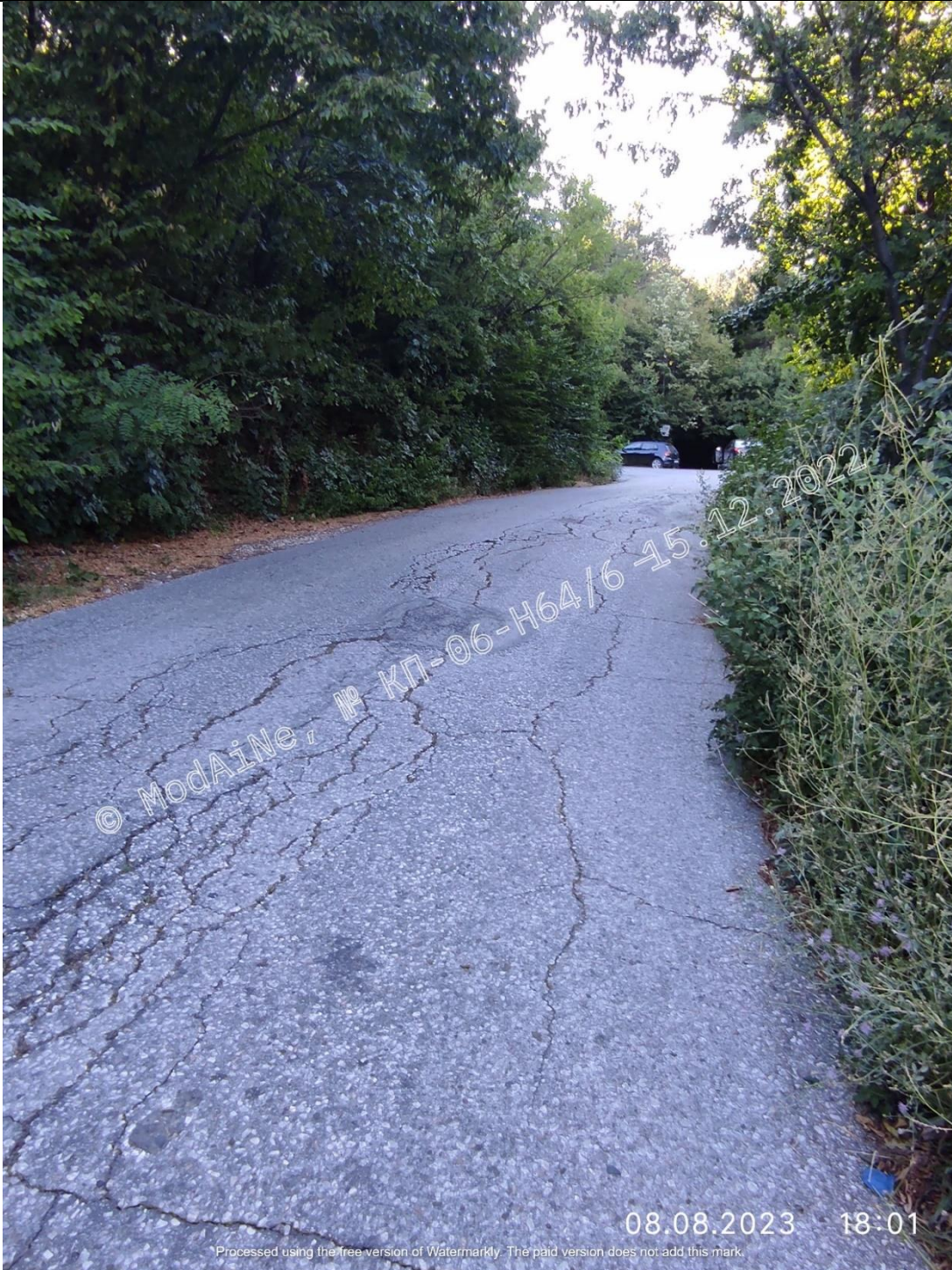
Състояние на сегмент от пътя между гр. Чепеларе и гр. Асеновград (т. DR_20230808_180109)
